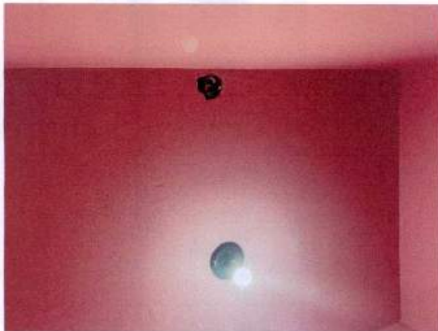
Imagem 26 – Banheiro 1, com ponto de energia no teto;
