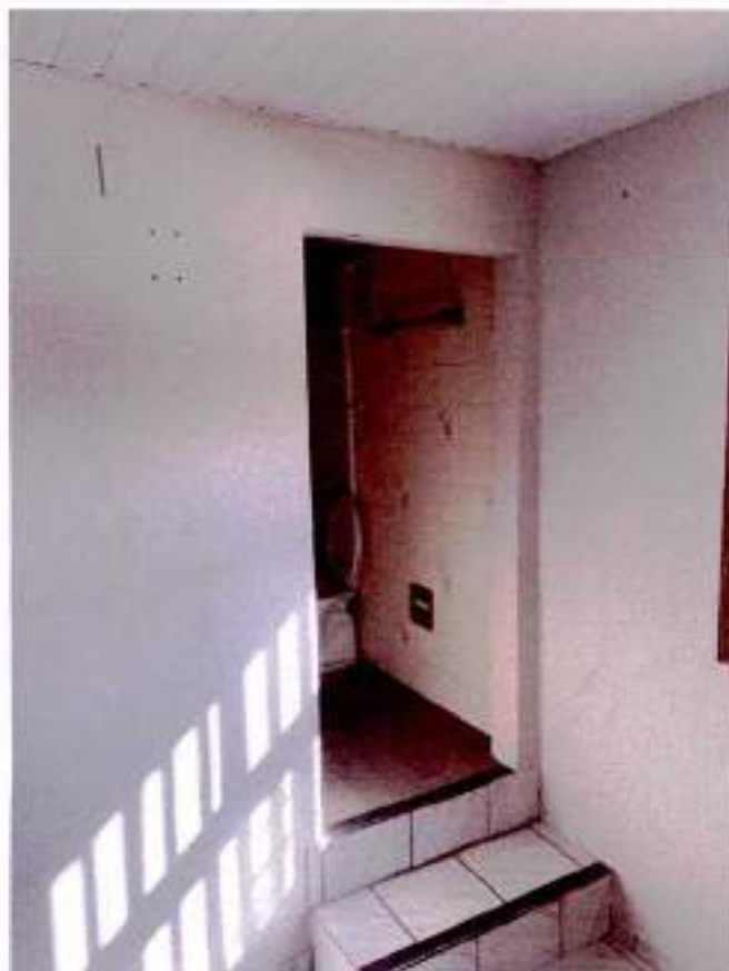
Imagem 38 - Pavimento superior (Sala 1) contém trincas na parede do banheiro;
