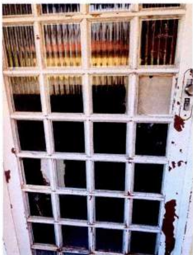
Imagem 56- área externa (vidros da porta do fundo quebrados);
