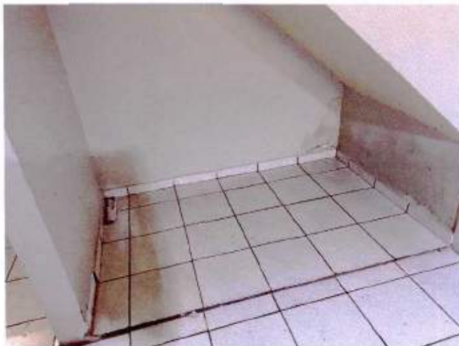
Imagem 18- Sala do fundo (sinais de umidade embaixo da escada);
