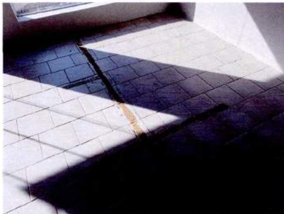
Imagem 4 - Marcas no piso (sala da entrada);
