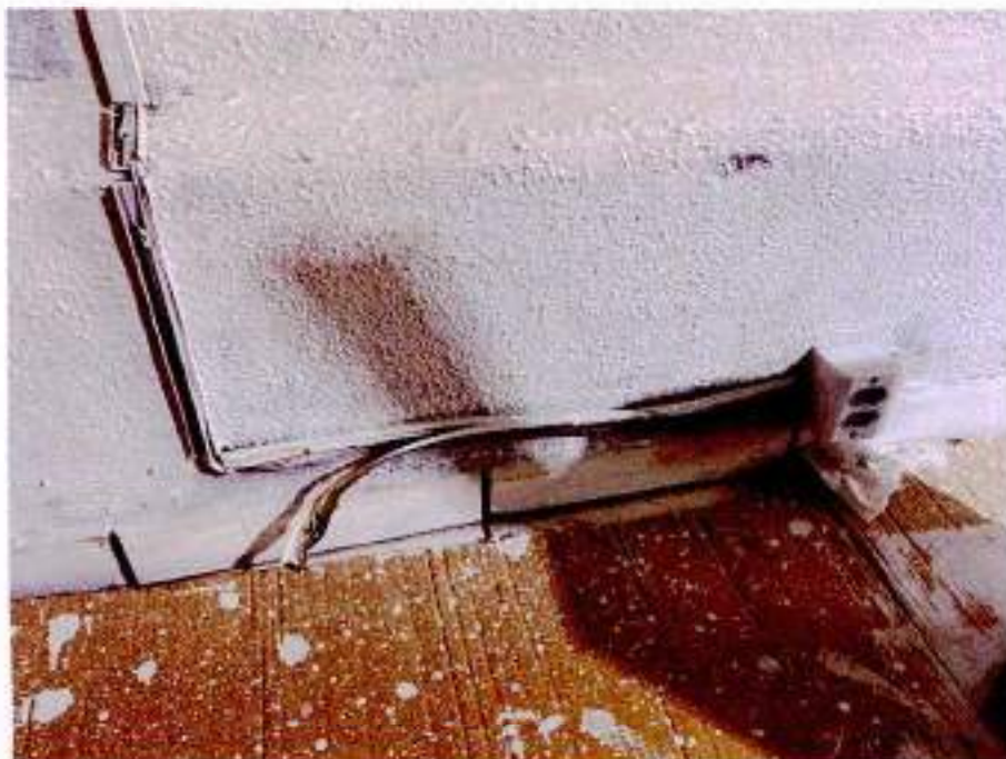
Imagem 14 - Sala do fundo (canaleta com fio exposto);
