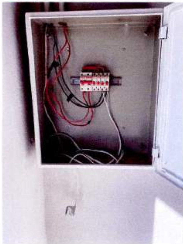
Imagem 3 - Caixa de energia (sala da entrada);
