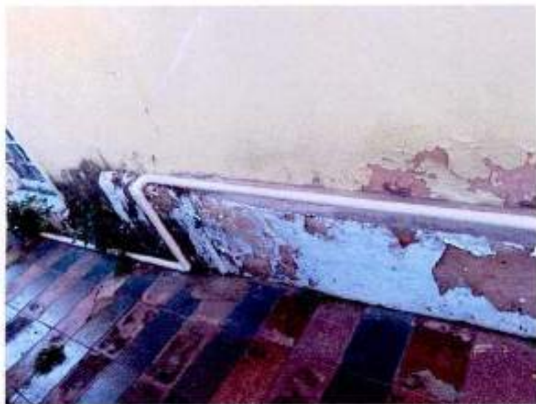
Imagem 49– área externa com umidade aparente;
