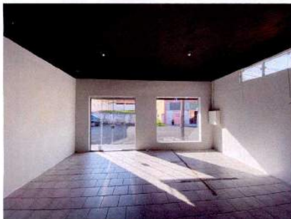
Imagem 2 - Sala da entrada (possui marcas no piso);
