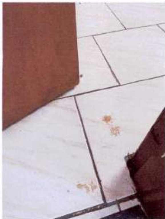
Imagem 43 - Pavimento superior (Sala 2) com sinais de cupim na porta;
