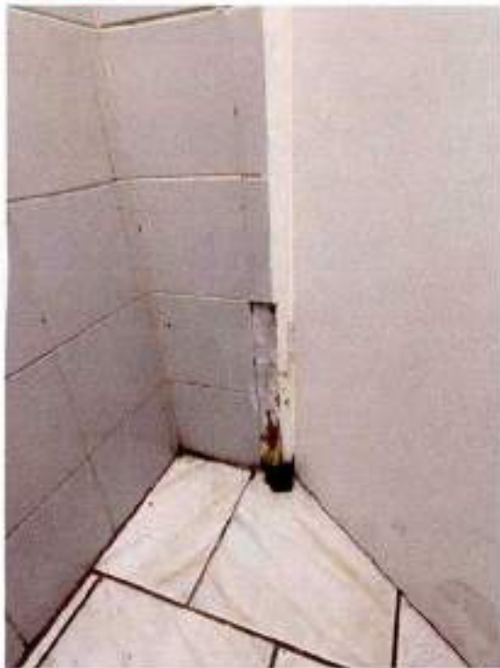
Imagem 29 – Banheiro 2 (faltando peças do revestimento da parede);
