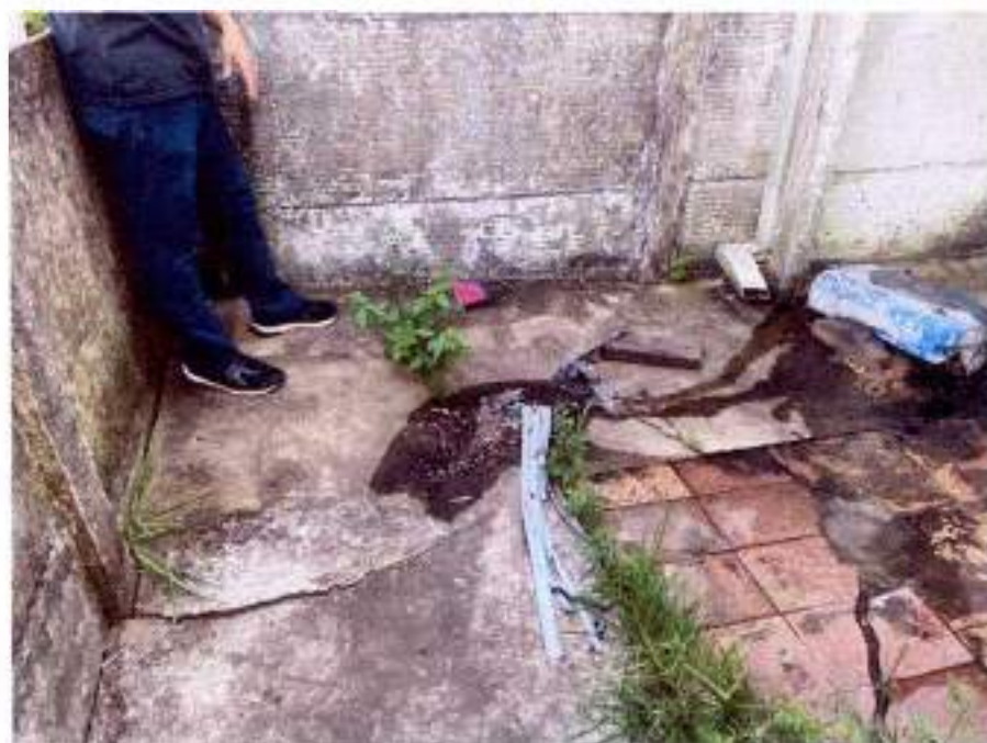
Imagem 52- área externa com afundamento de piso;
