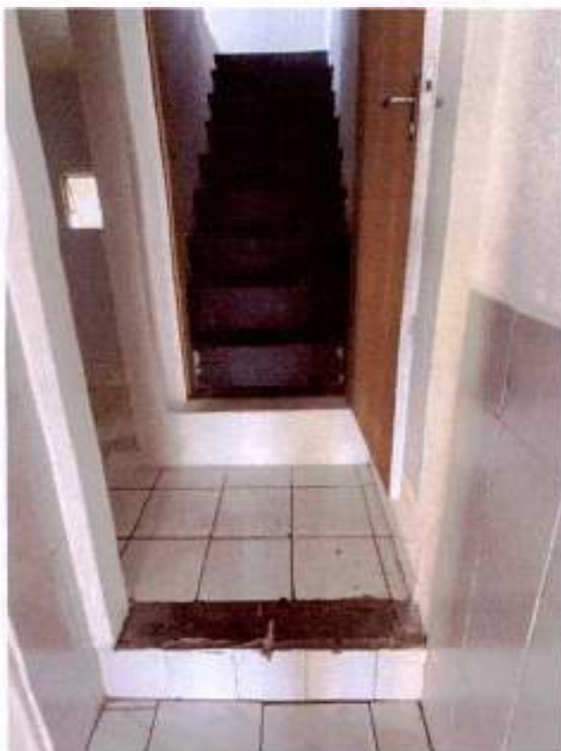
Imagem 22 – Escada de acesso ao pavimento superior com desgaste no piso e peças faltantes;
